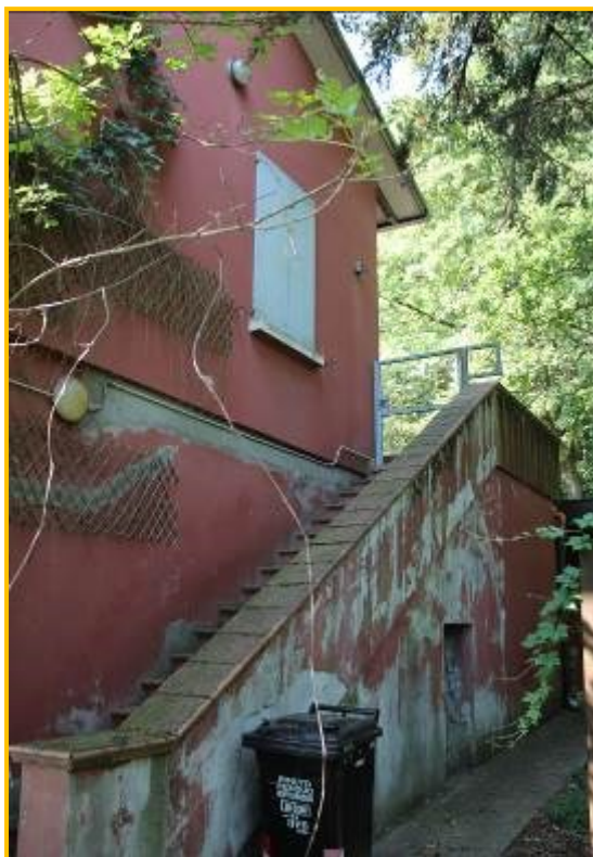
Degrado intonaci fronte nord (fonte: Committente)
